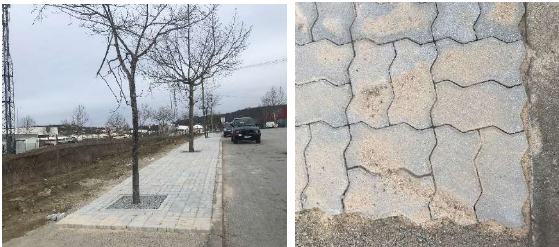
Figs. 78 y 79. Fotografías del pavimento a base de adoquines sobre lecho de arena, hechas en julio de 2022. Fuente: M. Rosario del Caz Enjuto (UVa).
