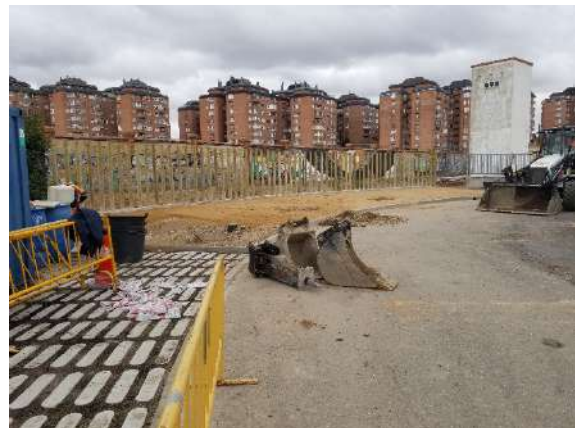
Fig. 58: Intervención en la rotonda de la calle Pilar Miró. Tratamientos previos de preparación antes de la aplicación de los distintos sustratos.
