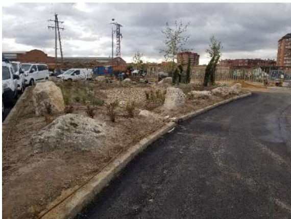
Fig. 57: Intervención en la rotonda de la calle Pilar Miró. Tratamientos previos de preparación antes de la aplicación de los distintos sustratos.
